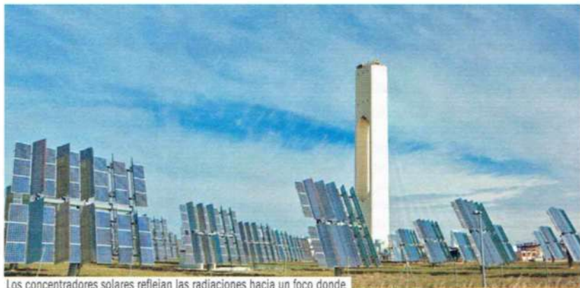
Los concentradores solares reflejan las radiaciones hacia un foco donde calientan un líquido para generar vapor y mover un generador eléctrico.
