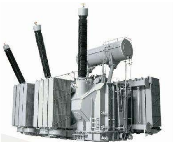
Fig. 4.37. Transformador usado en el transporte de energía eléctrica
