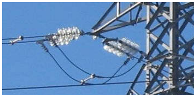
Fig. 1.16. Aisladores usados en un tendido de red eléctrica
