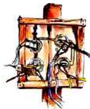
Instalaciones eléctricas no reglamentarias.
