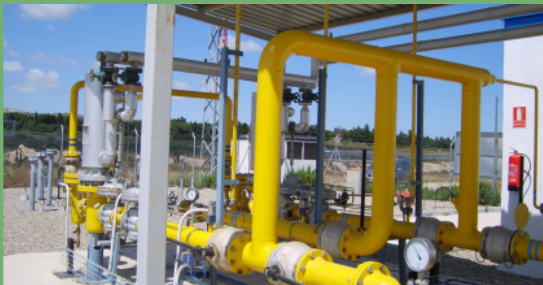
Estación reguladora de gas natural en un campo de extracción
