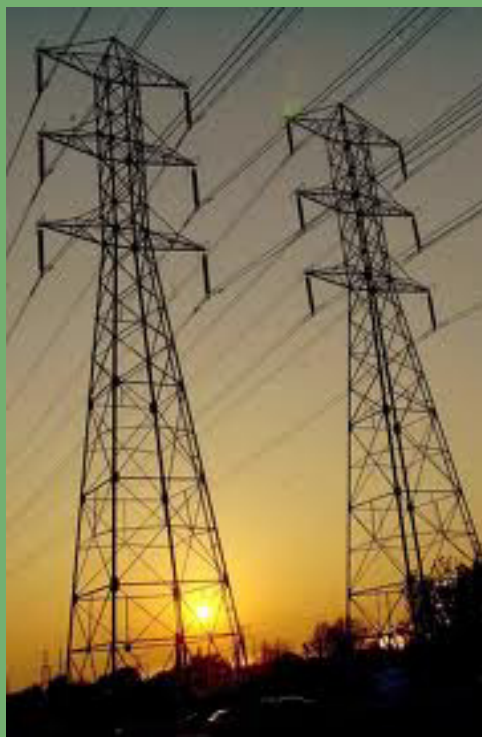
Líneas de alto voltaje de transmisión de la energía eléctrica
